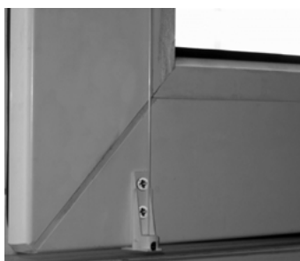
Рис. Установленный кронштейн без крышки
